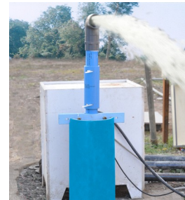
9 - Le forage est prêt à être utilisé.
